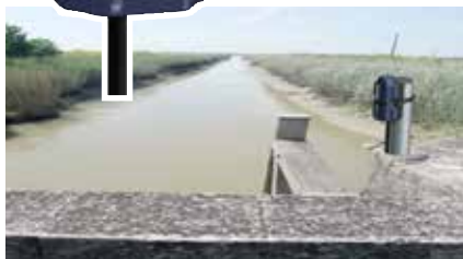
Esclusas en canales de riego
